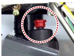
<Крышка вентиляционного хода открыта>
