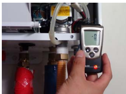
<Измерение давления подаваемого газа>
